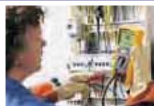
Проверка изоляции в распределительном щите
