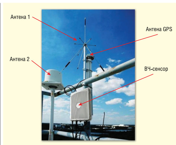
Рис. 4. ВЧ-сенсор і антени, встановлені на даху будівлі
